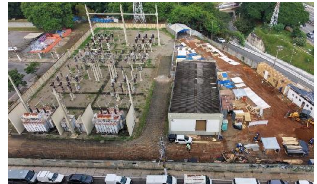
Subestação Anália Franco
