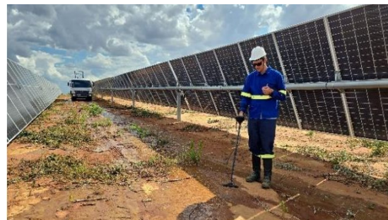
Equipamento para medição energia
